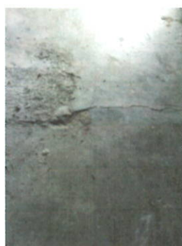
FOTO 3.: PISO. Sustrucción de torta alisada con fisuras en el piso
